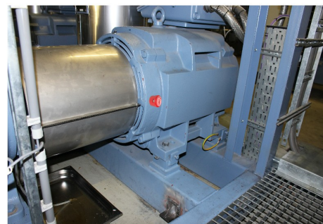
Capteurs de vibration 3 Axes placé à l'avant du moteur
