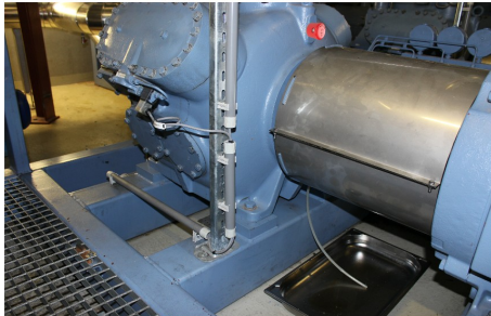
Capteur de vibration 3 Axes placé à l'avant du compresseur
